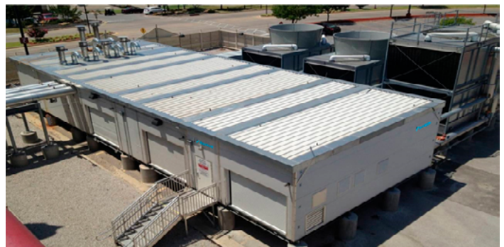
La planta y las torres de enfriamiento proveen capacidades para la Fase 1 y 2 de la construcción con capacidades adicionales programadas para 2017 y 2019.
