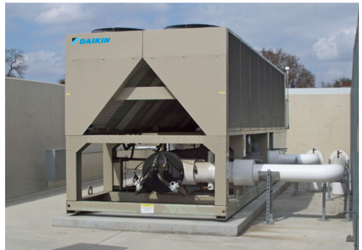
El enfriador Daikin Pathfinder de 210 toneladas instalado en la Clínica Whittier contribuyó a obtener puntos LEED en dos áreas de sustentabilidad – optimización de la eficiencia del sistema (EAc1) y mejoramiento de la gestión de refrigerantes (EAc4).
