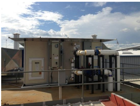
6 DAIKIN-MCQUAY AHU de 75 tons cada uno
