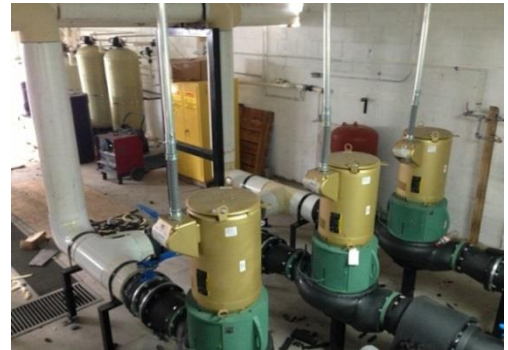
3 Bombas de Agua fría de 1,200 GPM cada una
