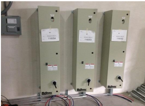
3 DAIKIN-MCQUAY VFD de 60HP para operar 3 bombas de agua fría
