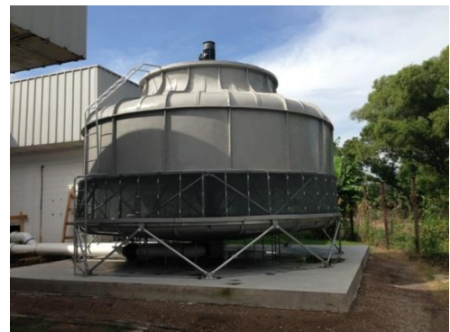
1 torre de enfriamiento de 700 tons
