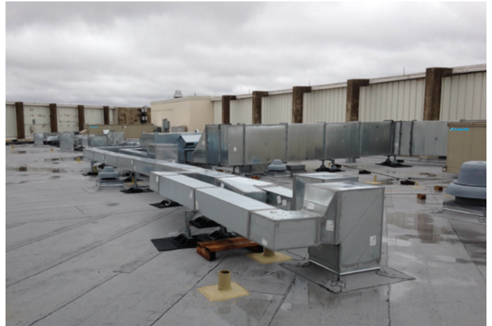
Leyenda de Foto: Las manejadoras de aire exterior personalizadas Daikin Skyline®, en conjunto con sistemas de recuperación de energía, rescatan energía del aire expulsado del edificio y contribuyen a la calificación ENERGY STAR de Marriott Quorum.
