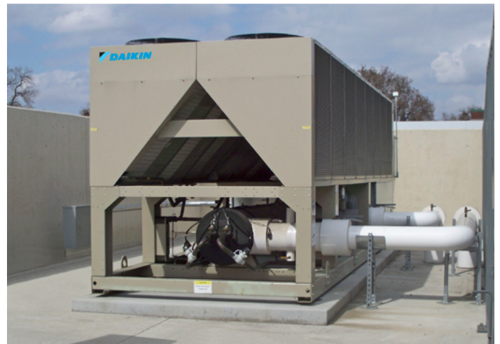
El enfriador Daikin Pathfinder de 210 toneladas instalado en la Clínica Whittier contribuyó a obtener puntos LEED en dos áreas de sustentabilidad – optimización de la eficiencia del sistema (EAc1) y mejoramiento de la gestión de refrigerantes (EAc4).
